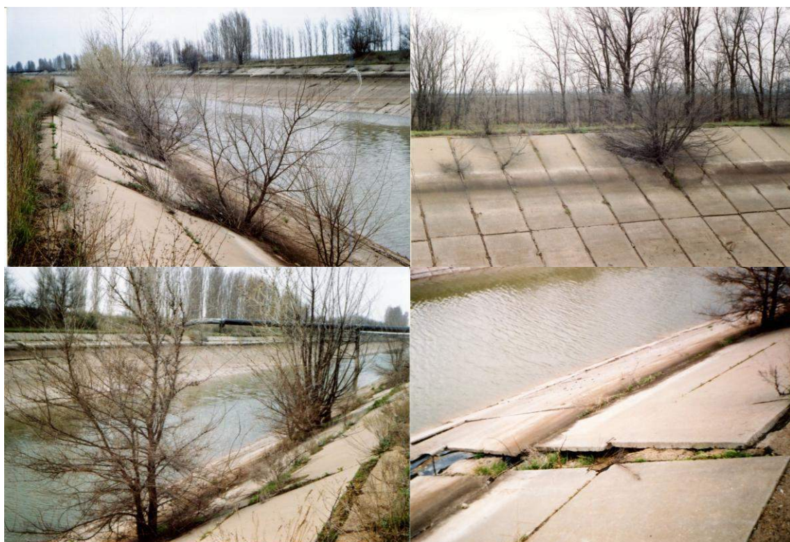
Рисунок 5. Раскрытие швов, локальное разрушение и поднятие панелей НПК в результате прорастания древесных растений на мелиоративных каналах Волгоградской области
